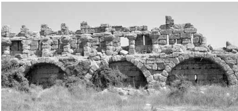
Ил. 7. Куртина Сиде, вид изнутри. Здесь на арках покоится нижний боевой ход, из которого наружу ведут щелевидные бойницы. Верхний боевой ход и парпет сохранились лишь фрагментарно. Фотография К. С. Носова
